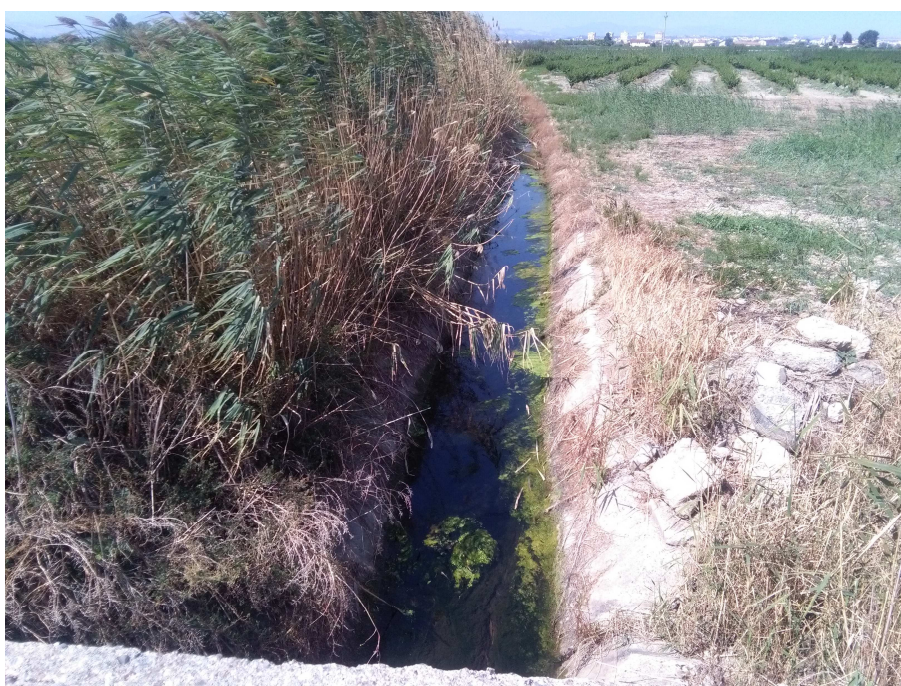
Figura 4 – Canale C8 a monte dell'impianto idrovoro di Via San Giusto.
