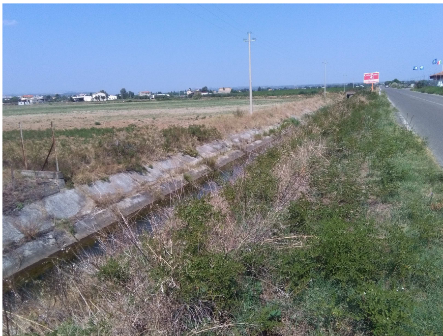
Figura 3 – Canale C9 a monte dell'impianto idrovoro di Via San Giusto.
