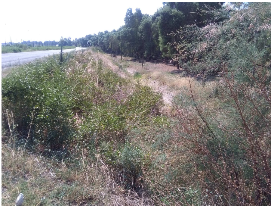
Figura 7 – Canale C5 in corrispondenza dell'impianto idrovoro su Via San Giusto.
